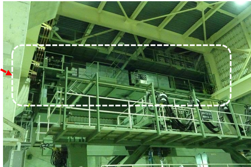
サイトバンカ建屋天井クレーン
