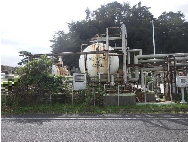
1号炉薬液タンク
