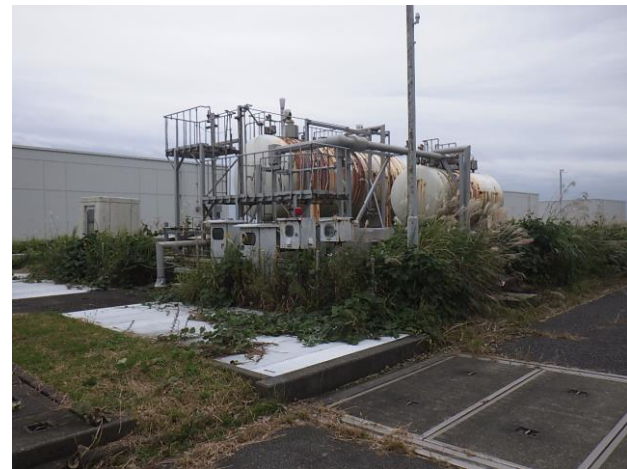
2号炉薬液タンク
