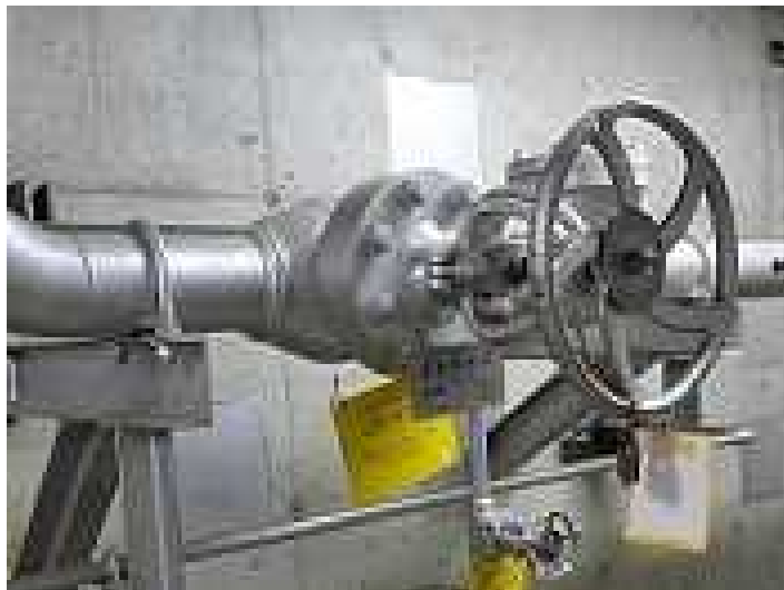
対象弁の隔離措置
