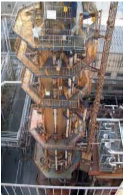
蒸解釜の全景。上部からチップを流し、 最下部で繊維を取り出す工程
