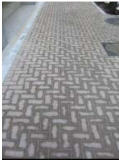
降雨明けの路面状況
