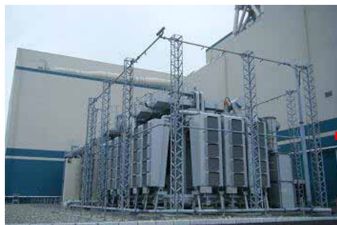
主変圧器の外観
