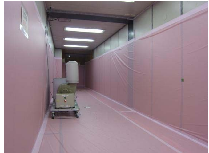
撮影日 : 平成23年6月13日 12時半頃 場所 : 廊下局所排風機
