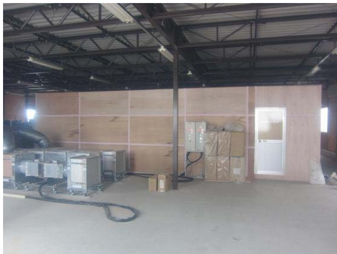
撮影日 : 平成23年6月12日 11時半頃 場所 : 局所排風機
