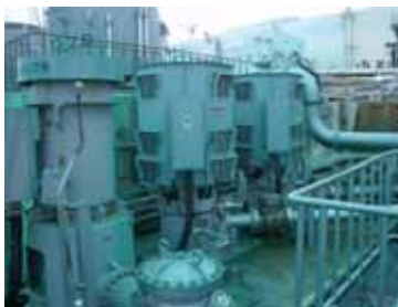
1号機 屋外海水設備 （主要海水ポンプ）
