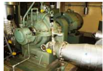
3号機 タービン補機冷却系ポンプ
