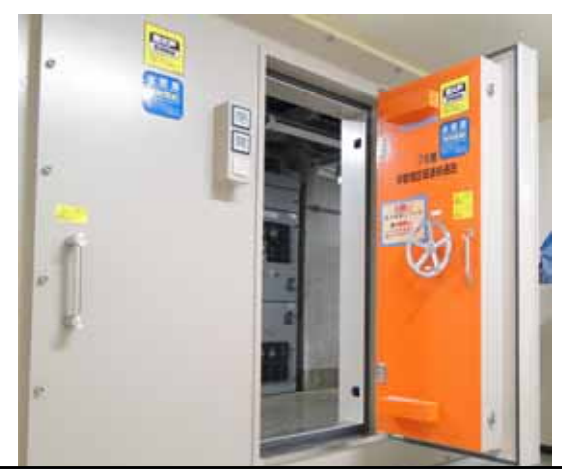
水密扉: 重要機器室への浸水を防止(約60箇所)
