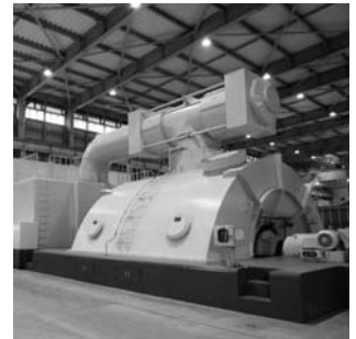
▲MACC発電 (川崎火力発電所)
