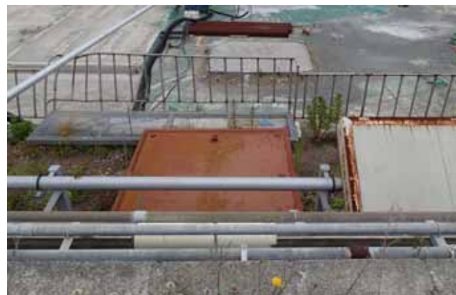
3号海側立坑閉塞状況
