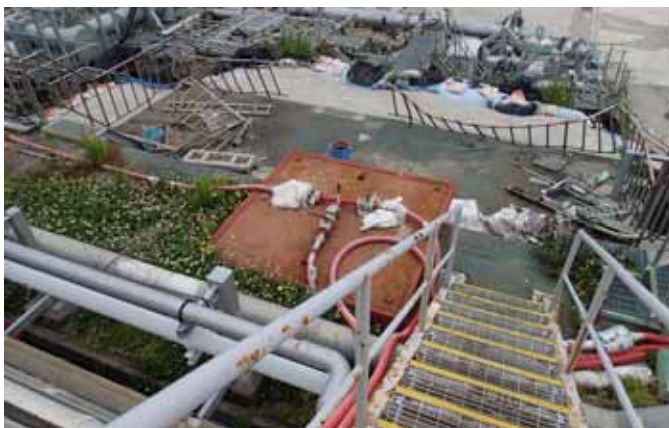
2号海側立坑閉塞状況
