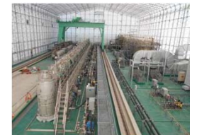
(高性能多核種除去設備)
