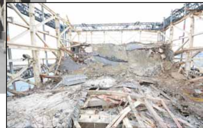
崩落屋根状況
