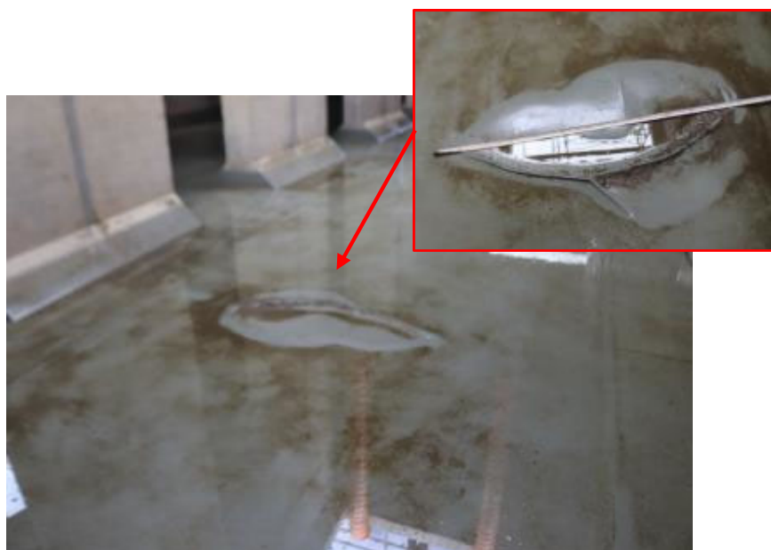
防水塗装膨れの状況
