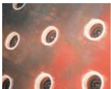
▲ 東扇島火力発電所のボイラー内部バーナー口 Burner outlet in the boiler at the Higashi Ohgishima Thermal Power Station
