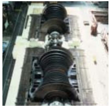
▲ 袖ヶ浦火力発電所の蒸気タービンの羽根車 Steam turbine blades at the Sodegaura Thermal Power Station
