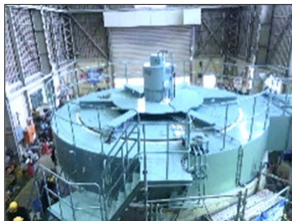
<改修後の発電機>
