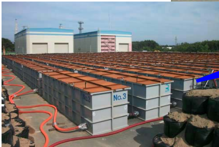
鋼製横置きタンク
