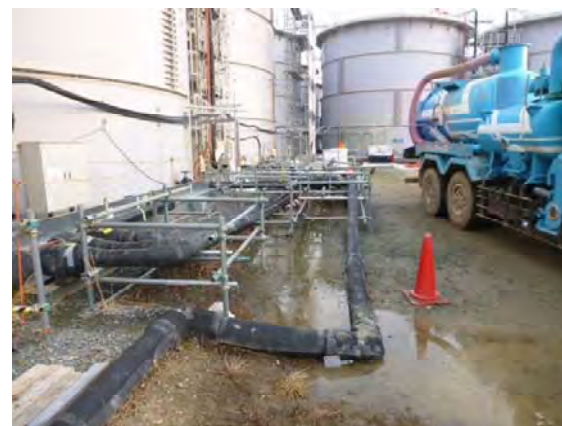
漏えいの状況 (①エリア)
