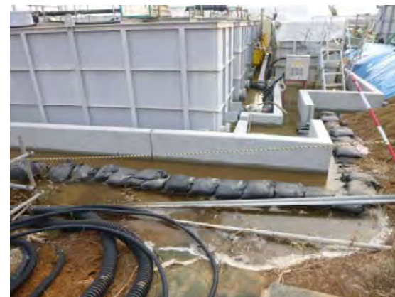
漏えいの状況 (③エリア)
