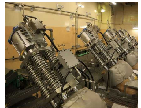
確認する弁の例 主蒸気隔離弁
