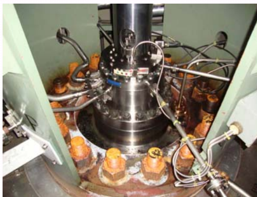
スタッドボルトの錆 (平成24年2月16日撮影)
