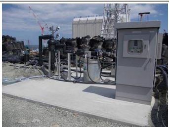
揚水井は密閉構造を採用
