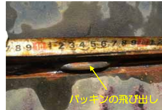
解体前の漏えいパス部底板裏面
