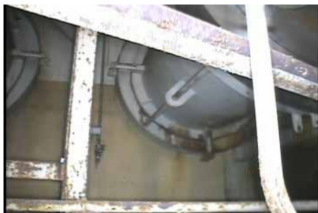
主蒸気配管B
