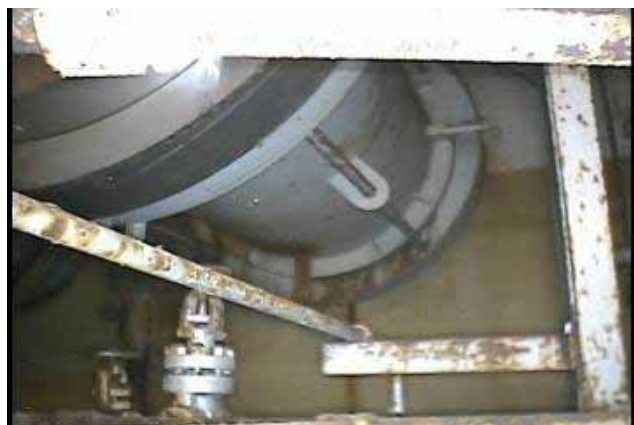
主蒸気配管C
