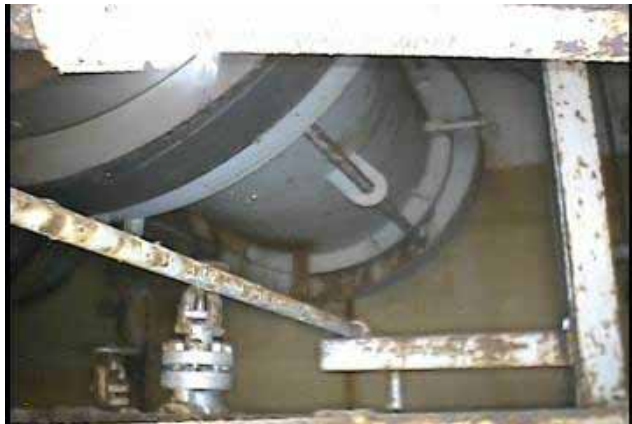
主蒸気配管C
