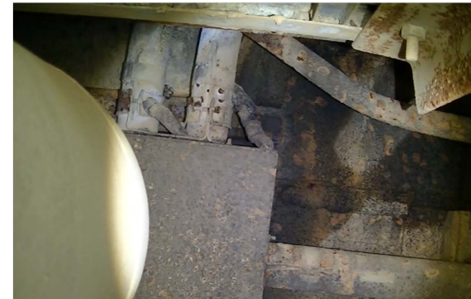
流入箇所下部の写真
