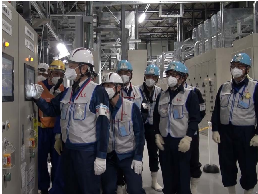
運転開始操作の様子 (1台目)
