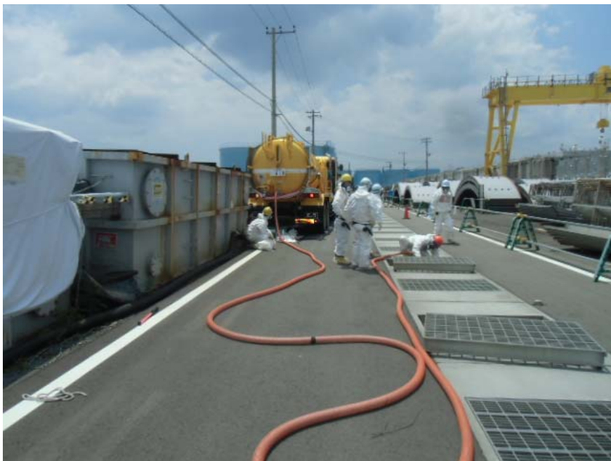
[漏えい発生場所] G1タンクエリアノッチタンク (清掃・水回収作業状況)
