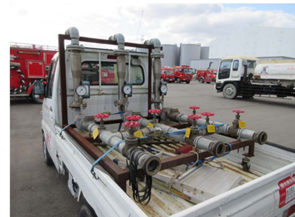
仮設ヘッダー （1～3号機へ配分、 流量調整に使用）
