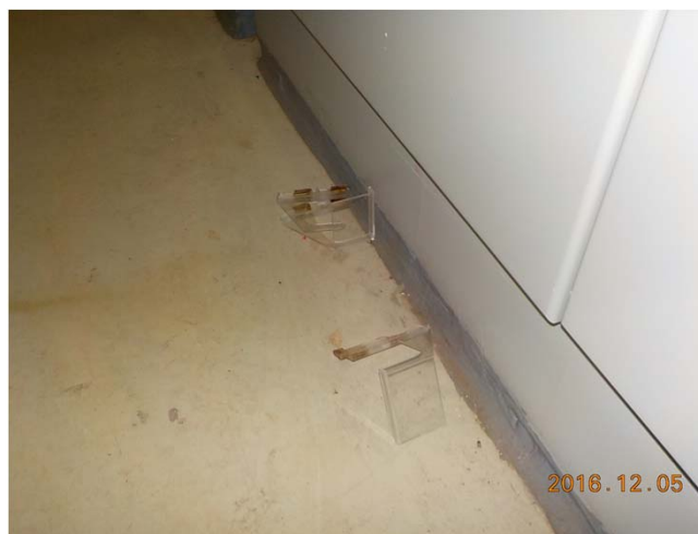
破損したカバーの状況
