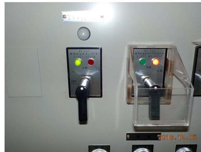
ポンプの起動停止用スイッチ(カバーなし)
