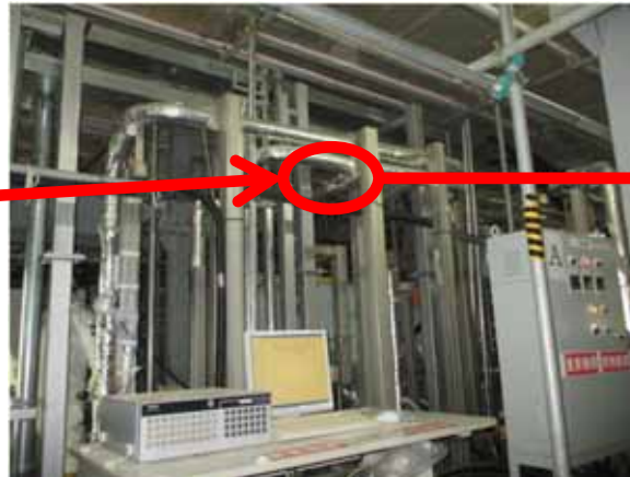
図 1 : 当該弁 設置場所
