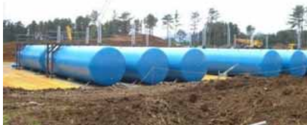
高濃度滞留水用タンク ( 遮へいのため地中埋設済 )
