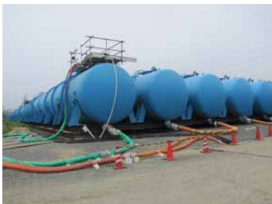
濃縮廃液用タンク （濃縮海水用としても使用）
