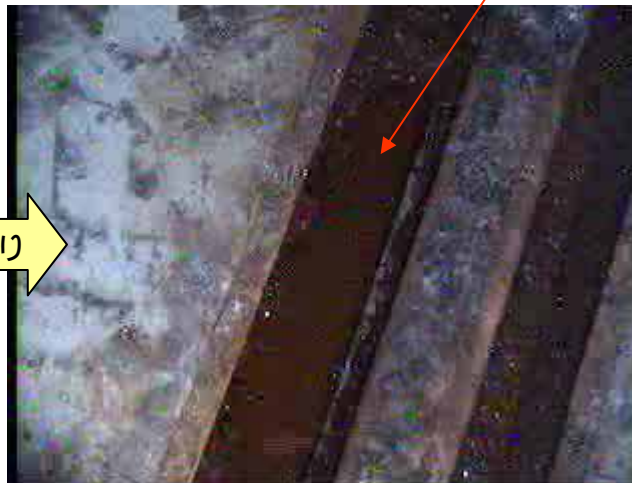
レール溝 拭き取り後
