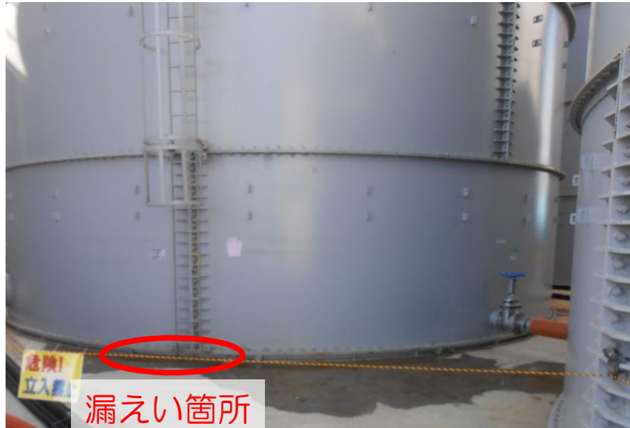
<漏えいタンク>
