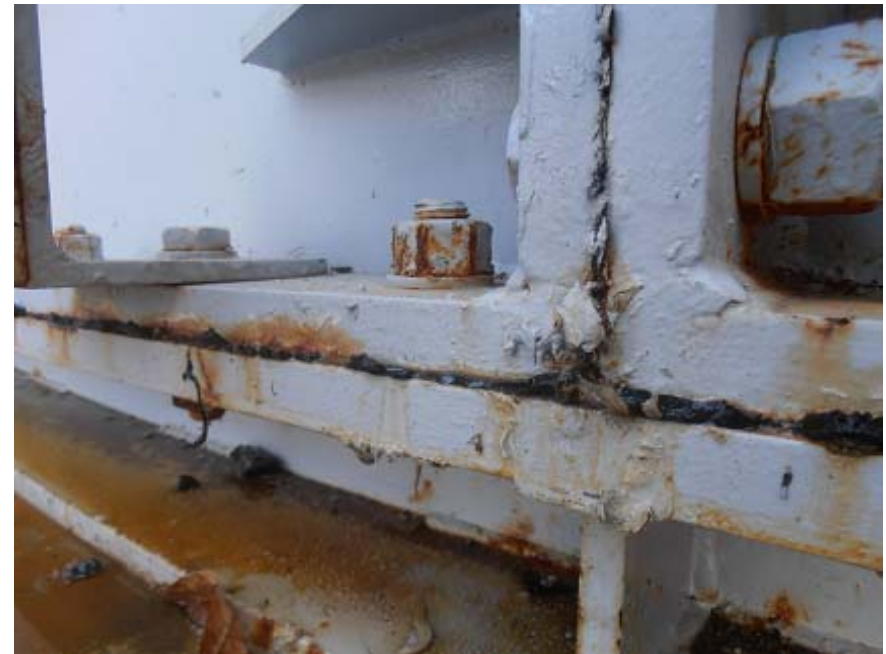
<漏えい箇所近影>
