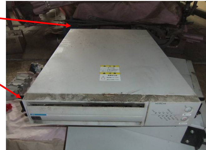
取り外したUPS (故障UPS)
