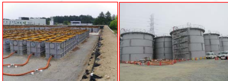
淡水用、RO濃縮水タンク
