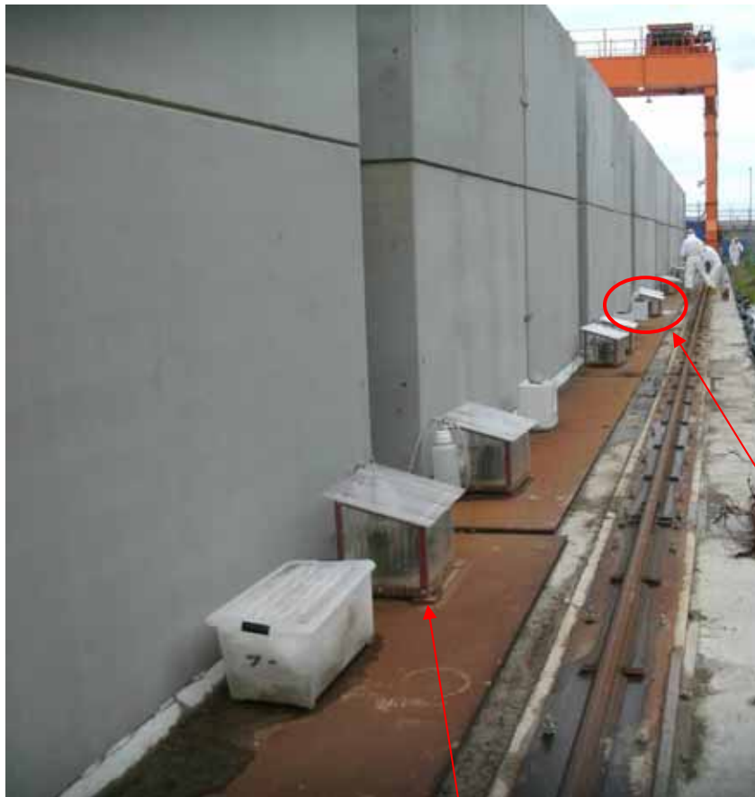
ポンプの雨除けハウス
