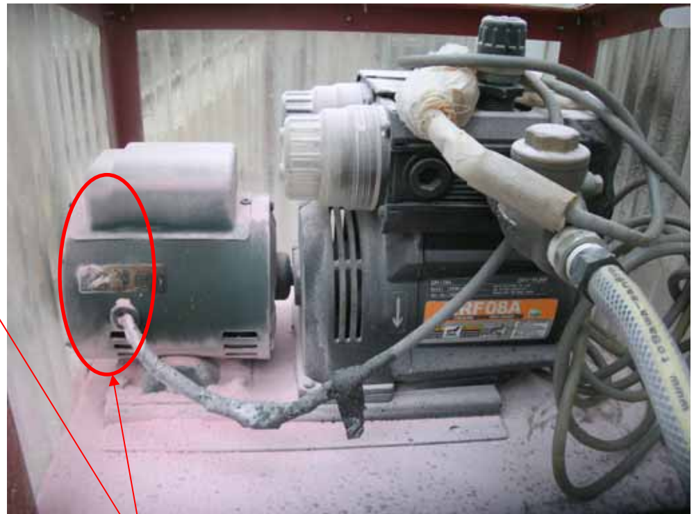
発煙発生箇所
