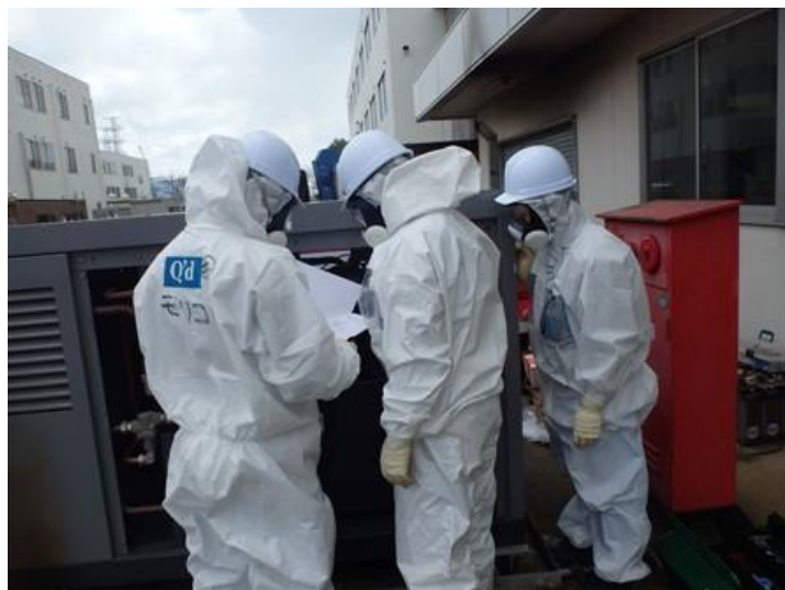
窒素供給設備用空気圧縮機点検風景
