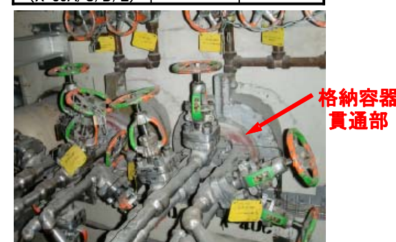
図2：2号機圧力容器代替温度計現場調査結果
