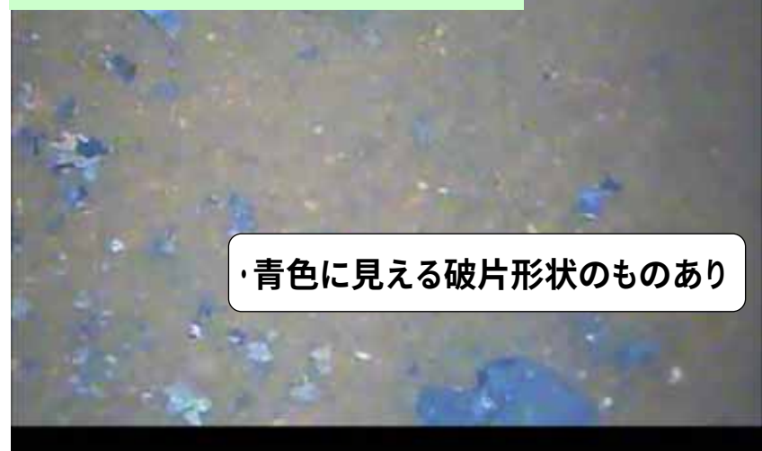
⑧ 格納容器底部（表面）【接写】
