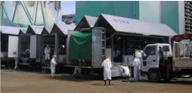
塩分除去 逆浸透膜 (RO) 装置
