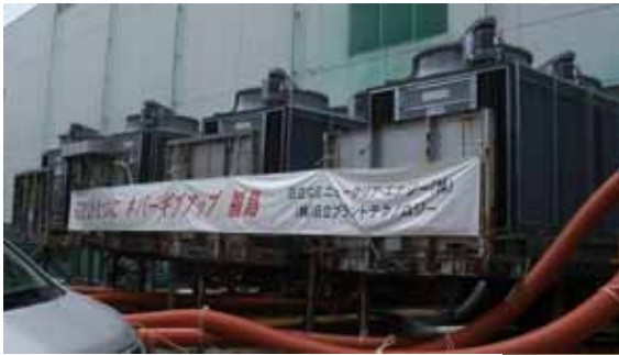
使用済燃料プール 循環冷却装置
