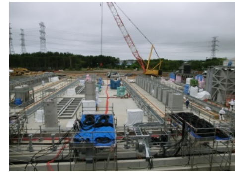
多核種除去設備設置エリア全景 (7/21)
