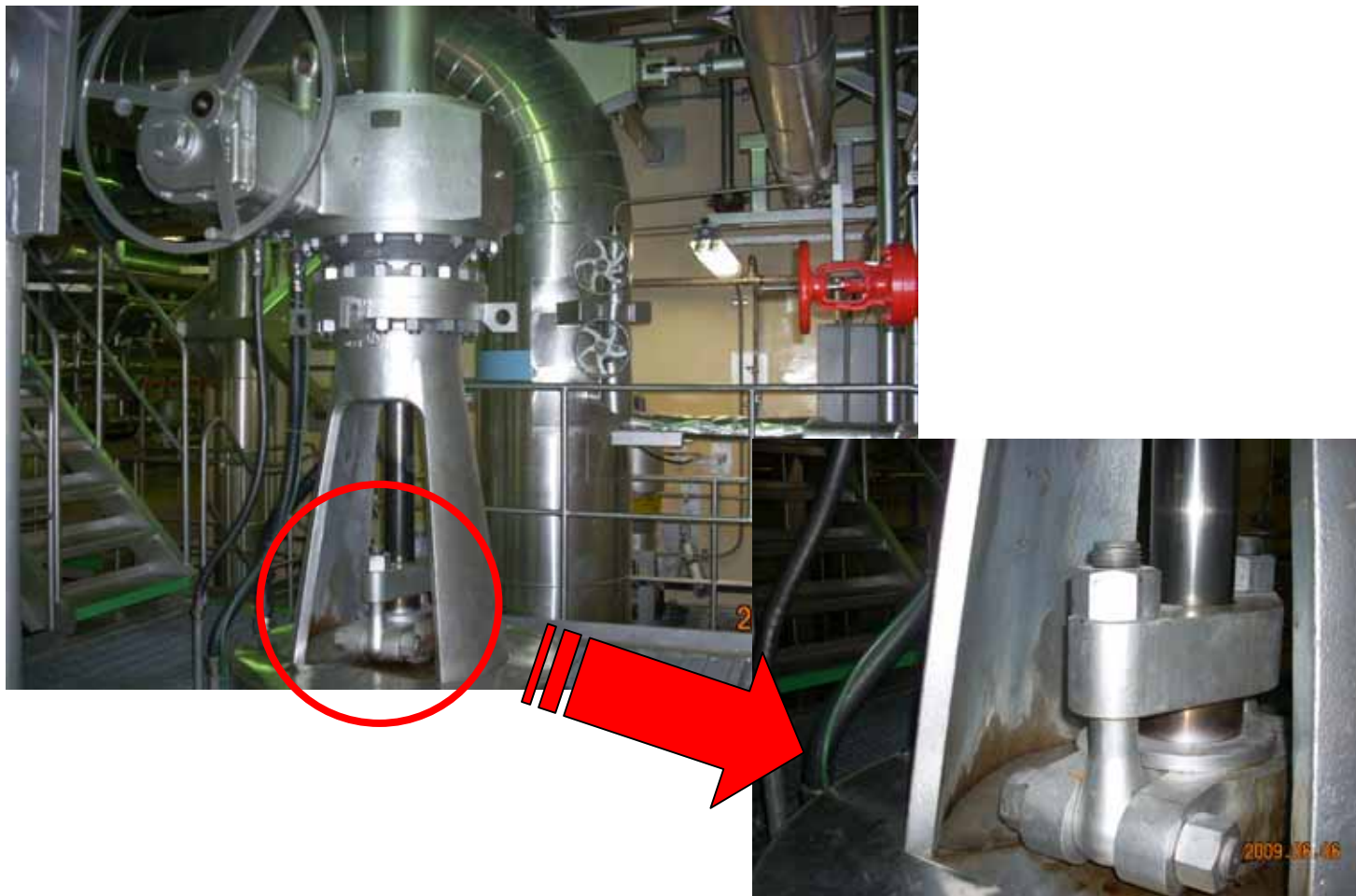
タービン駆動原子炉給水ポンプ（A）吐出弁
