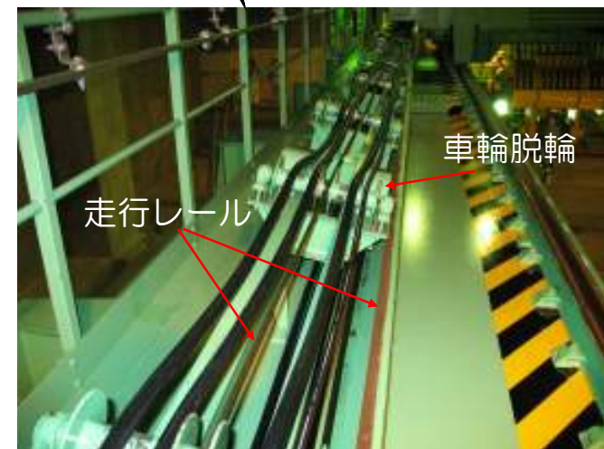
ケーブルベア脱輪状態
