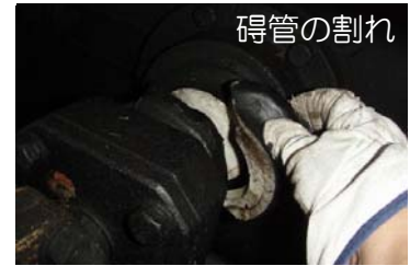
二次ブッシングの破損
