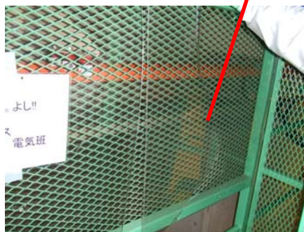
運転席後方アクリル板損傷
