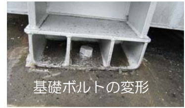
基礎ボルトの変形
