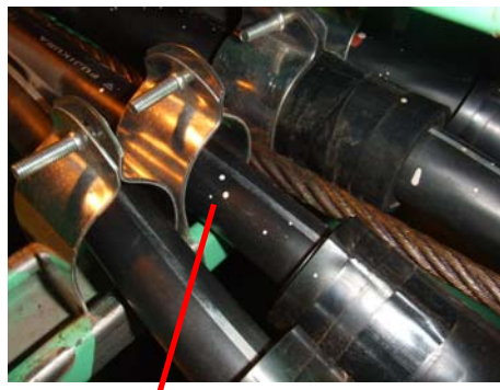
ケーブルボックスゴムカバー破れ
