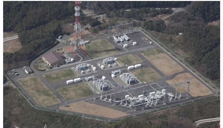
新木更津変電所
