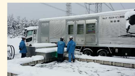
積雪環境でのガスタービン発電機車の運転訓練
