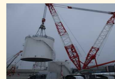
飛来物の衝突に耐えるよう鋼板が厚い軽油タンクへ取替
