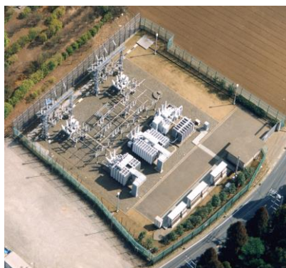
配電用変電所（18万7000ボルト） 8.9マイクロテスラ（89ミリガウス） 〈測定ポイント：敷地境界から0.2m、 地表0.5m, 1m, 1.5m ※値は3点の平均
