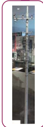
▲ 昭和後期の配電柱 (1階)
