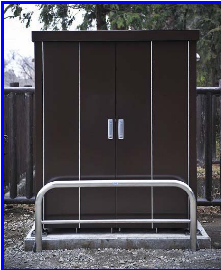
20kW EV充電装置 疏水の水車で発電した電気も利用
