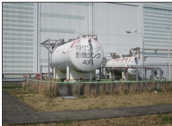
4号炉 薬液タンク
