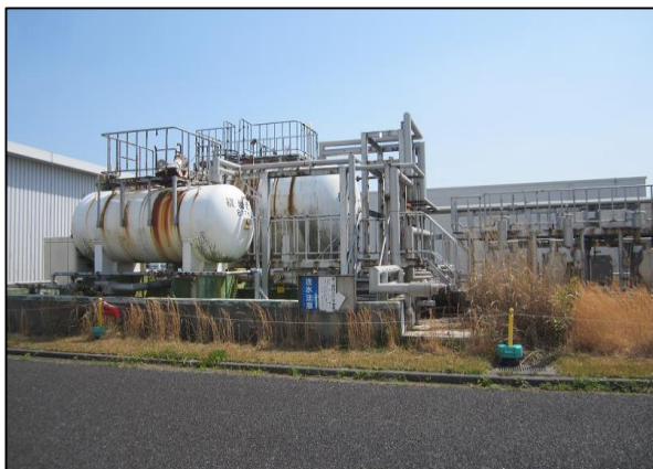
3号炉 薬液タンク
