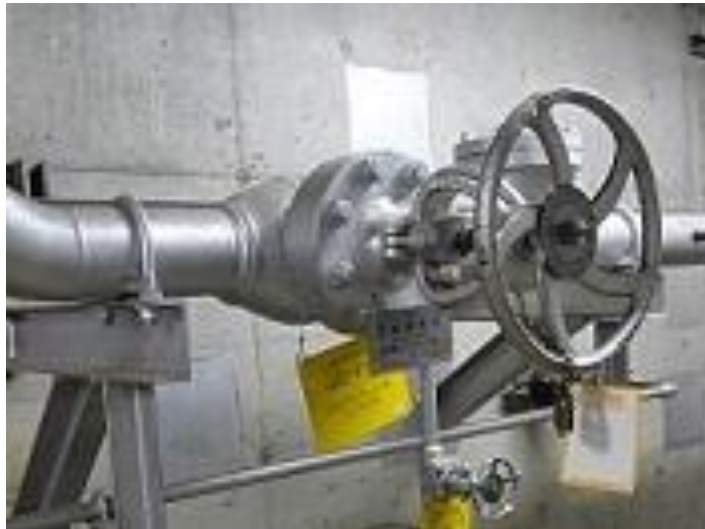
対象弁の隔離措置
