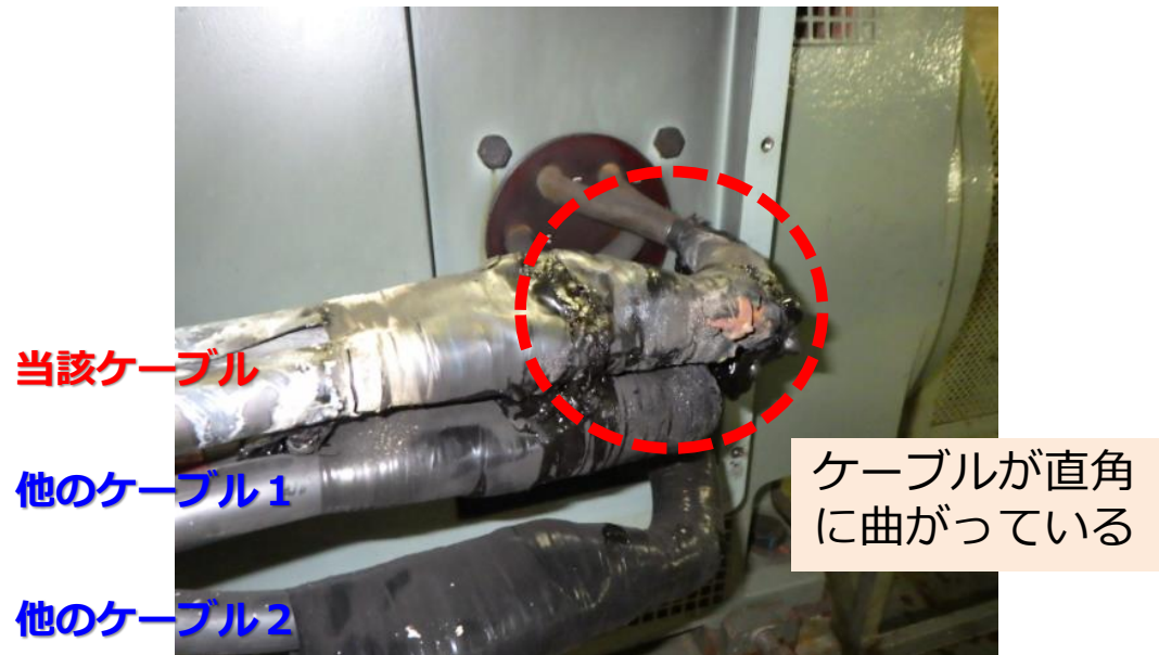
端子箱を外した中の状況
