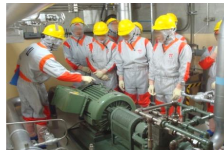
冷却した使用済燃料プールの 水を循環させるポンプ
