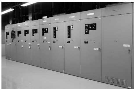
取り替え前の電源盤
