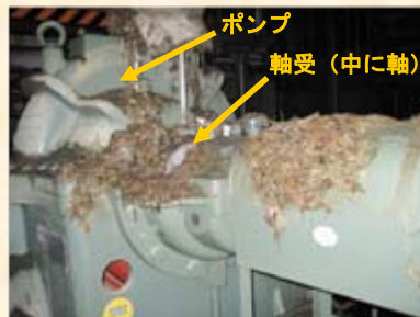
津波によるポンプの被水状況 (撮影日：平成23年3月23日)
